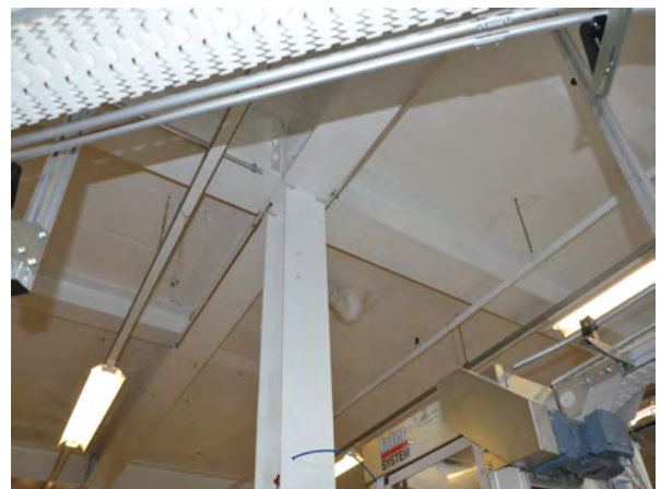
Gebäude B2, Halle EG
