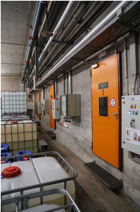
Blick auf die Installations-Zugänge zu den Regalgassen im UG
