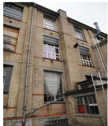
Rechts: Ofenhausanbau mit beschädigtem Kamin; teilweiser Fensterersatz
